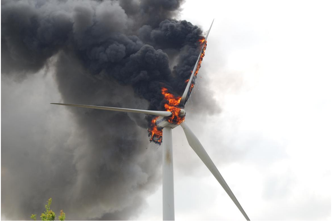
Buxtehude, Brand einer Windkraftanlage im Juli 2008.
